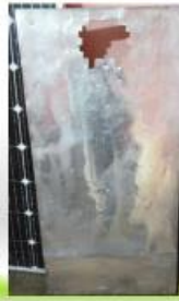
Tôle aluminium à l'arrière du PV
