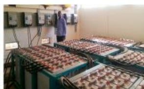
(b) Parc de batteries et d'onduleurs
