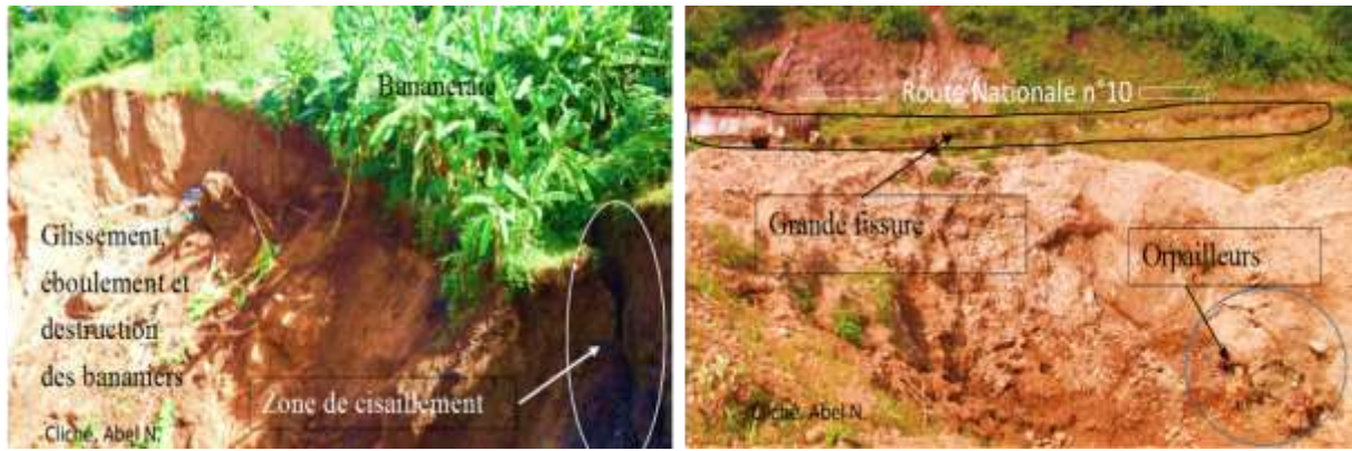
Image 3: Eboulement et route menacée à Rugogo
